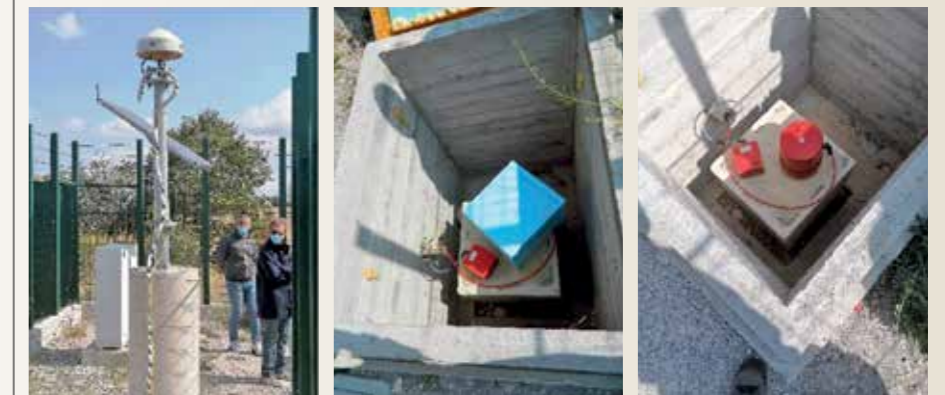
Fig. 3: Foto della stazione multi-parametrica Armento di ultima generazione, con alimentazione a pannelli solari e batterie. La stazione è composta da GPS (basso a sx), sismografo a breve periodo (cilindro rosso) e accelerometro cubo rosso, installato su un plinto di cemento scollegato dalle pareti dello scantinato. Per garantire un ottimo isolamento termico, entrambi i sensori sismici sono installati all'interno di un pozzetto di cemento armato e vengono poi coperti da polistirolo (da Danesi et al., 2020).
